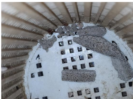
Рис. 6. Отложения в корзине предварительного фильтра
