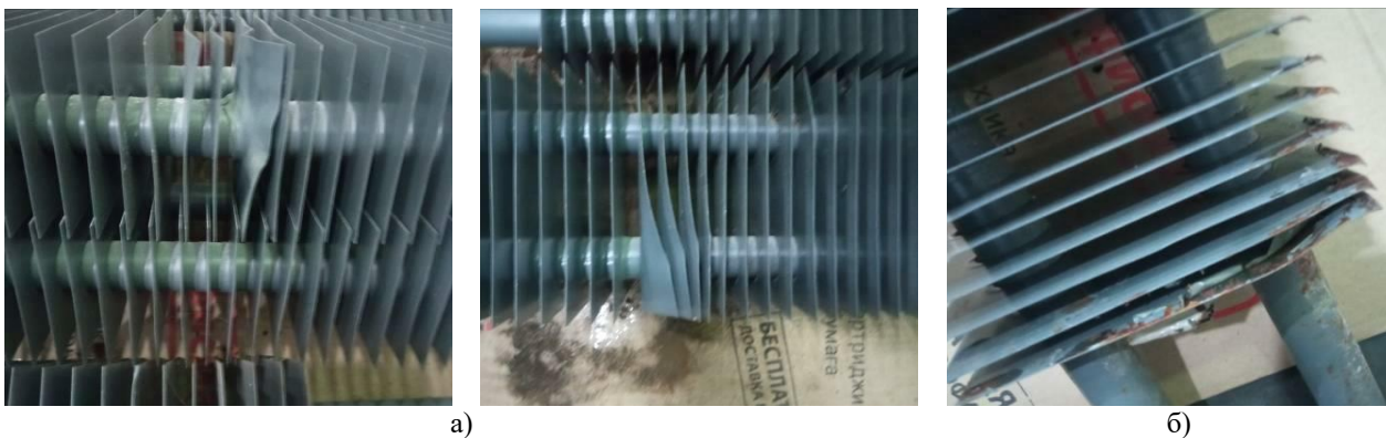
Рис. 2. Механические повреждения оребрения отопительных приборов (конвекторов)
