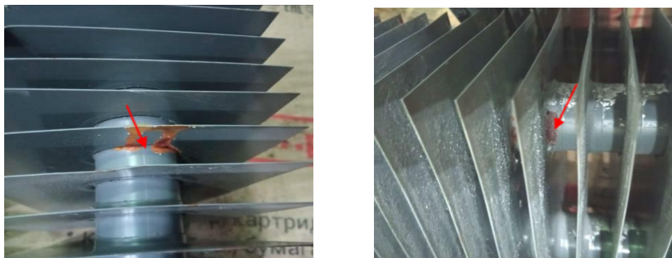
Рис. 4. Потеки ржавчины на отопительных приборах
