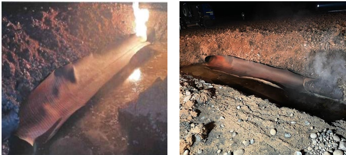
Рис. 3. Производственный заводской брак основного металла газопровода (участок магистрального газопровода Невинномысского ЛПУМГ, 14.12.2021) [3]
