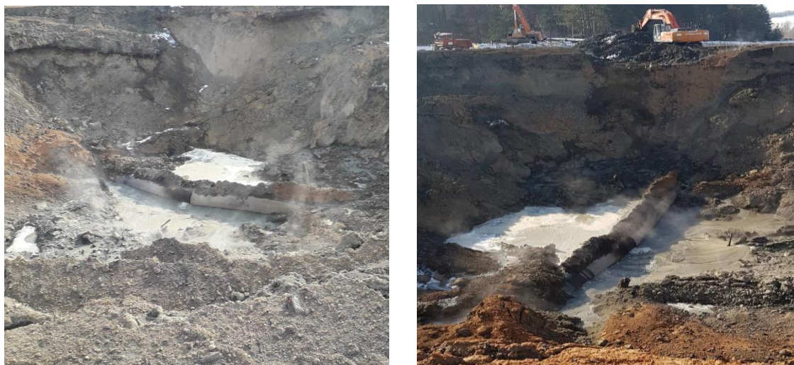
Рис. 4. Развитие трещины в околошовной зоне сварного соединения вследствие дефектов, образовавшихся по причине нарушения технологии сварки (2445 км магистрального газопровода «Ямбург-Тула-1», 03.03.2018) [3]
