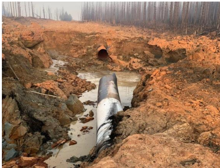
Рис. 1. Коррозионное растрескивание под напряжением (КРН) в основном металле трубы (участок 1158,2 км –1181,1 км магистрального газопровода «Ямбург–Поволжье» 06.05.2019) [3]
