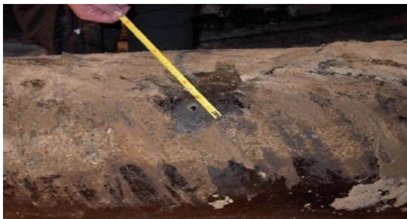
Рис. 5. Участок существующего трубопровода, пораженного коррозией под действием сероокисляющих бактерий [1]
