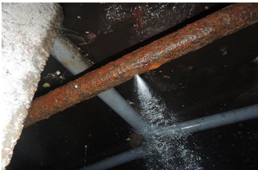
Рис. 1. Свищ на трубопроводе [2]
