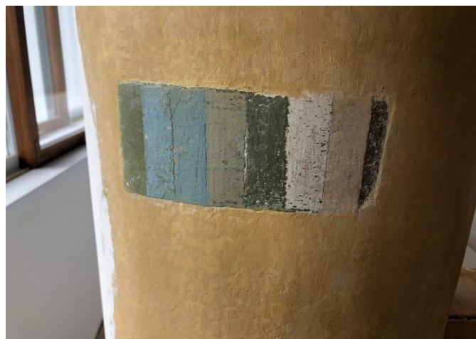
Рис. 4. Раскрытие слоев краски на колонне
