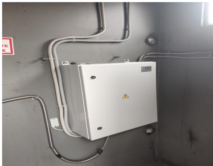
Рис. 2. Контроллер телеметрический «ССофт: Сигнал» в помещении ГРП [2]
