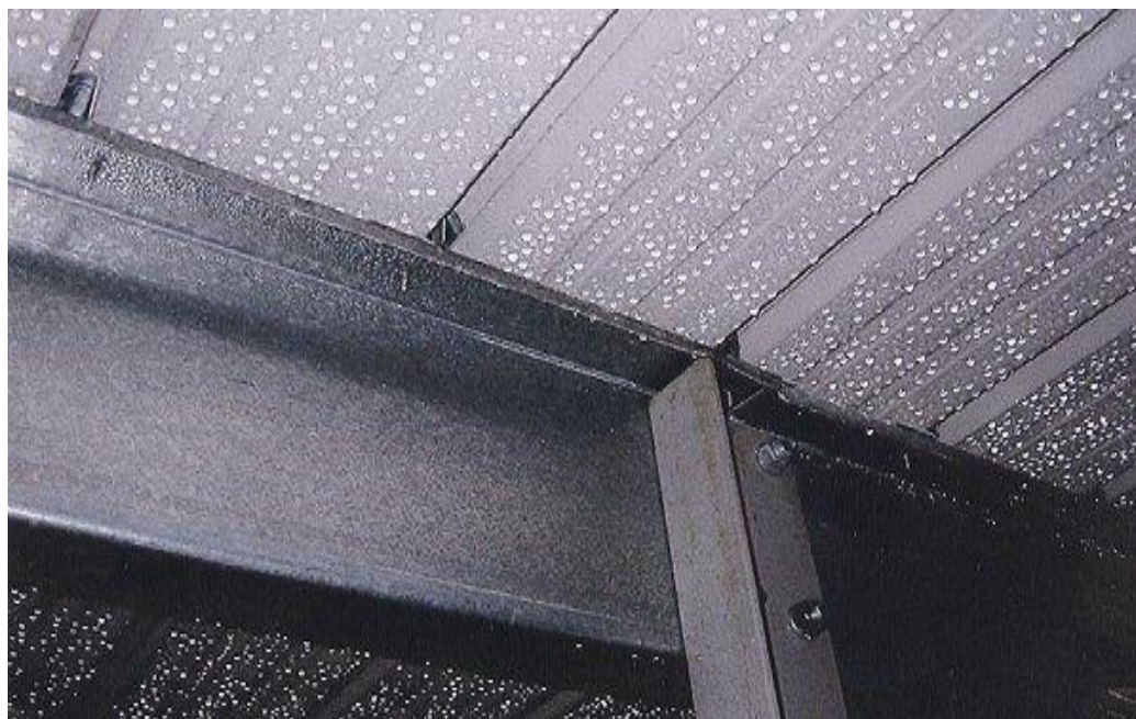
Рис. 2. Образование конденсата на поверхности металлических конструкций [6]
