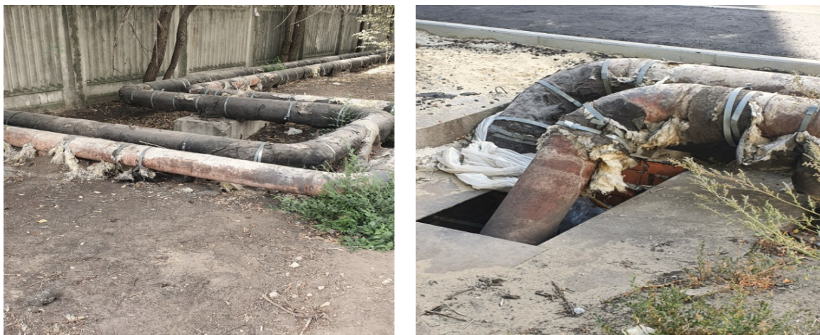
Рис. 3. Неудовлетворительное техническое состояние теплоизоляционных конструкций [6]
