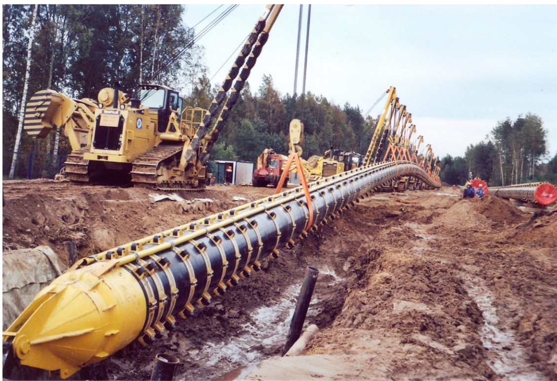
Рис. 1. Переход нефтепродуктопровода через автомобильную дорогу
