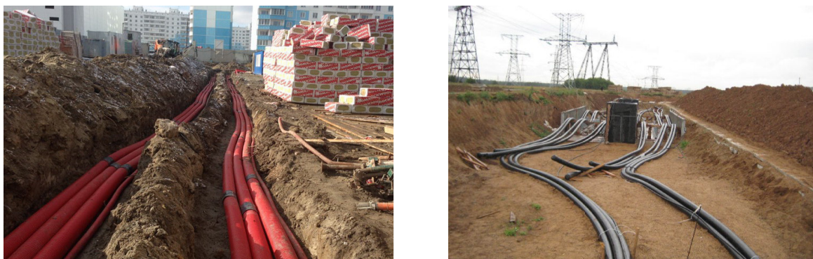
Рис. 6. Кабельные линии электропередачи
