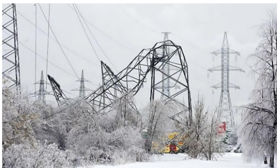
Рис. 2. Деформация опоры линии электропередачи при воздействии на нее ветровой нагрузки
