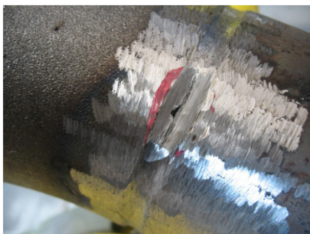
Рис. 3. Трещина в сварном соединении
