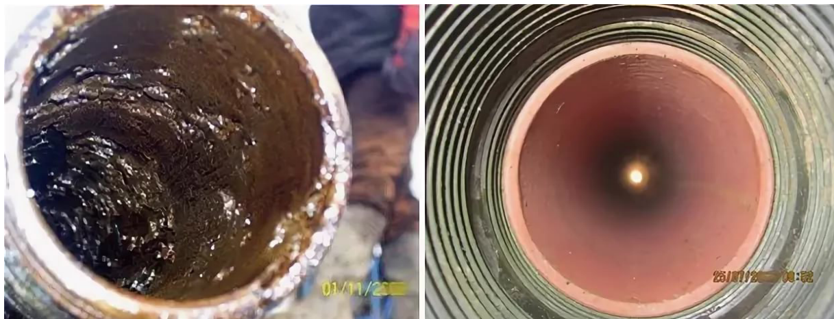
Рис. 3. Сероводородная коррозия: до и после
