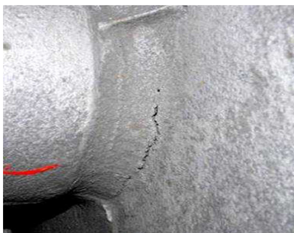
Рис. 4. Трещина в корпусе задвижки
